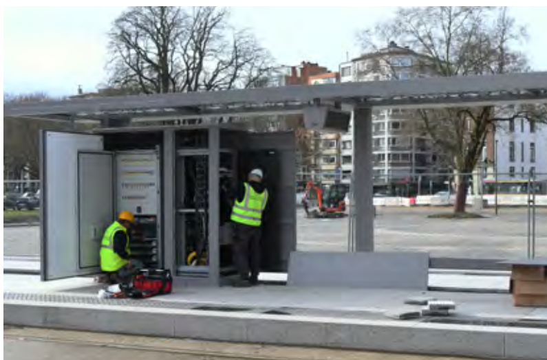
Station Charlemagne - févr. 2024
